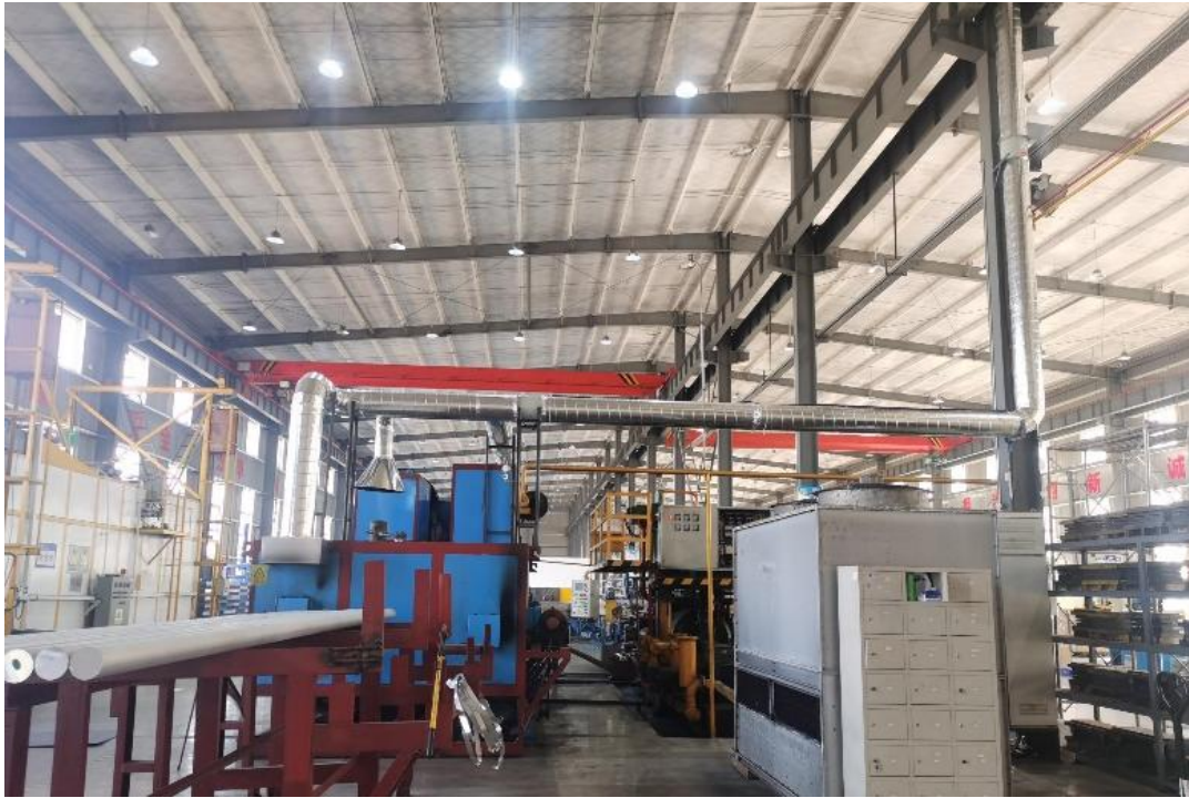
铝棒加热炉排气筒 (DA001)
