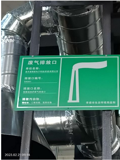
铝棒加热炉排气筒 (DA001)
