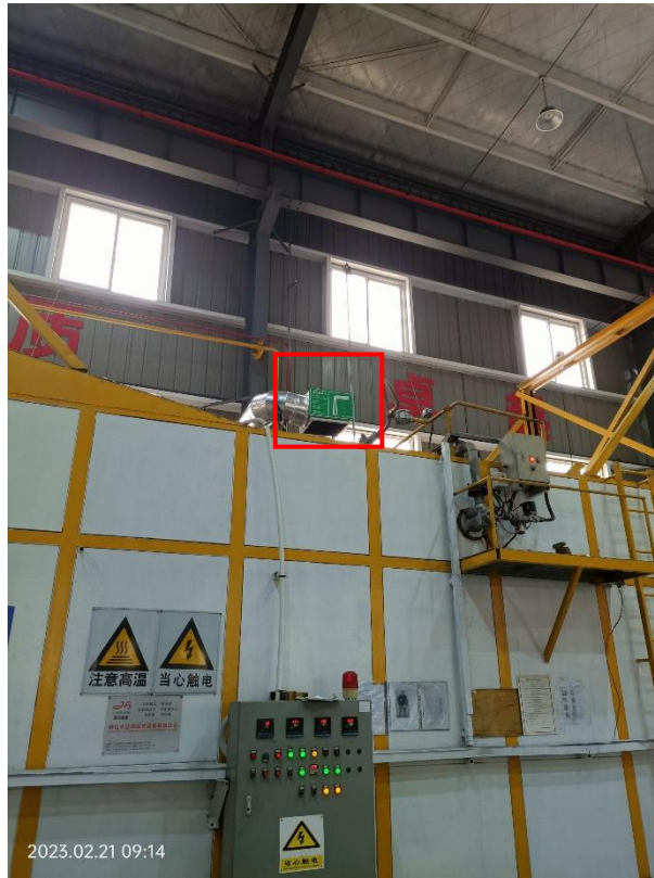
时效炉排气筒 (DA003)
