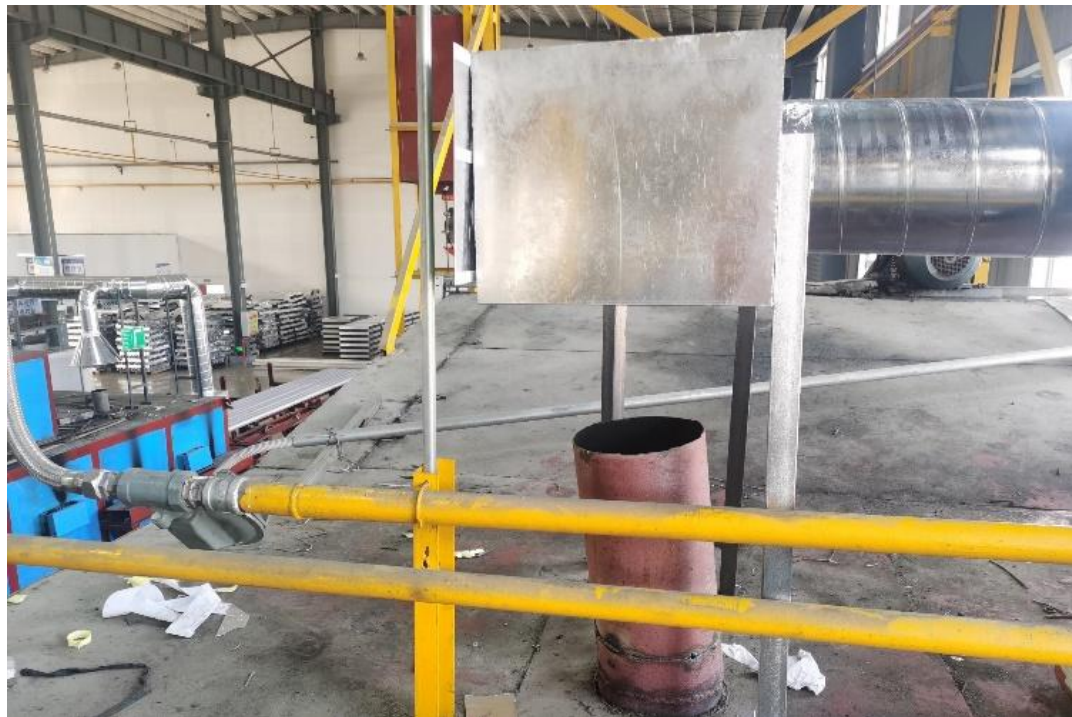
时效炉排气筒 (DA003)
