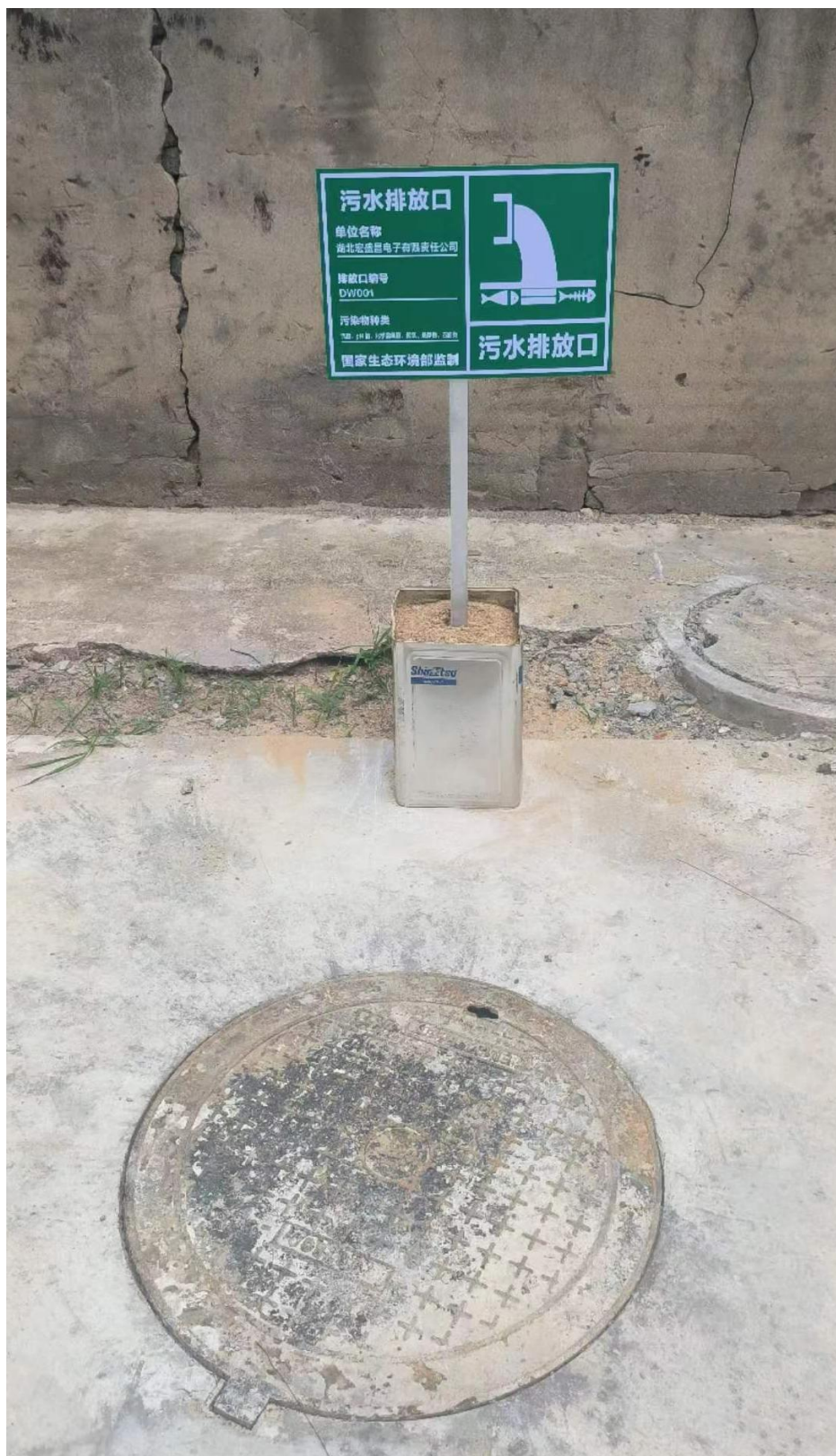
DW001 厂区污水总排放口及标识牌
