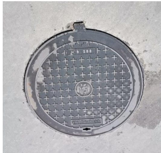
生活污水排口
